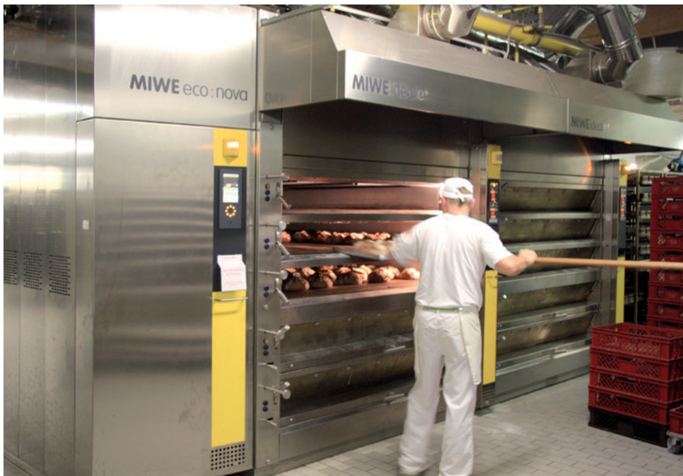
Zwei MIWE ideal e+ werden vornehmlich für Brot genutzt. Direkt daneben die MIWE eco:nova, die zusätzlich durch die Abwärme der HKZ gespeist wird.
