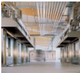
Stikkenofenbatterien mit optimierten Entsorgungsleitungen
